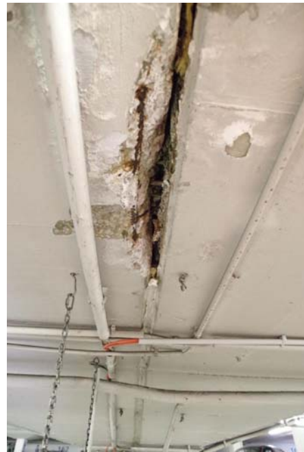
Abbildung 1: Betonabplatzung aufgrund von Bewehrungskorrosion im Fugenbereich
