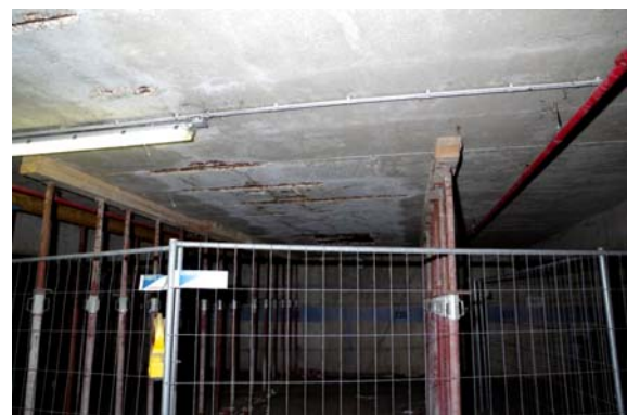
Abbildung 2: Maßnahmen zur temporären Sicherung der Standsicherheit
