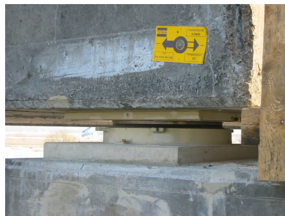
Widok zamontowanego łożyska
