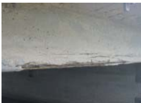
Uszkodzenia żelbetowych dźwigarów mostu
