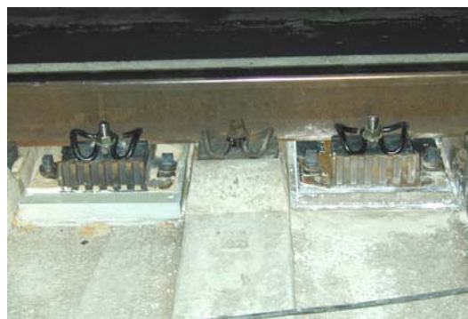
Abb. 15 : Eingebaute Reparaturstützpunkte DFF 300-1 in Winter- (li.) und Regelvariante (re.) mit gelöster Regelbefestigung (mi.) und Spannklemme in Vormontagstellung
