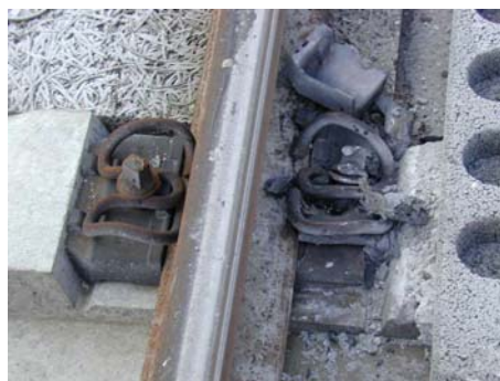
Abb. 3: Zerstörter Schienenstützpunkt und Schwellenhöcker nach Entgleisung im Umfahrungsbereich Melk ÖBB Bauart Fertigteilplatte Porr [9]
