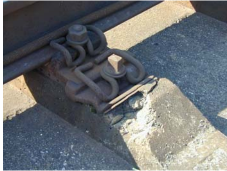
Abb. 2: Betonabplatzung am Schwellenhöcker der Bauart Rheda (Dachau – Karlsfeld)
